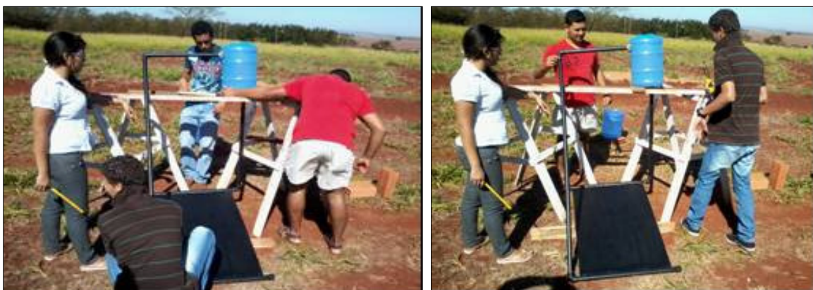
Figura 2. Acoplamento do reservatório ao sistema de aquecimento solar.
