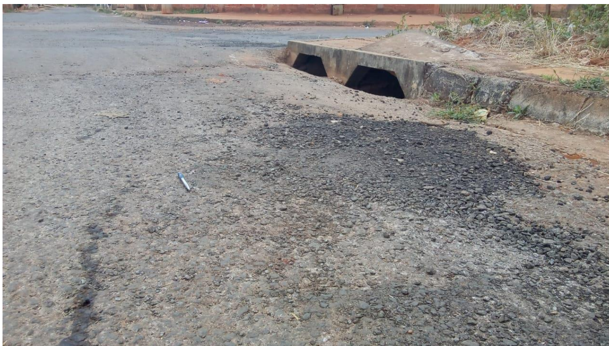
Imagem 1 – Assoreamento: Residencial Jardim do Lago
