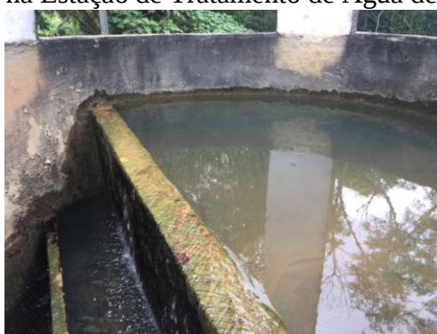
Foto 2 – Filtro Russo utilizado na Estação de Tratamento de Água de Morro Agudo de Goiás.
