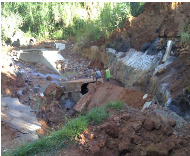
Figura 7: Processos erosivos na área do parque
