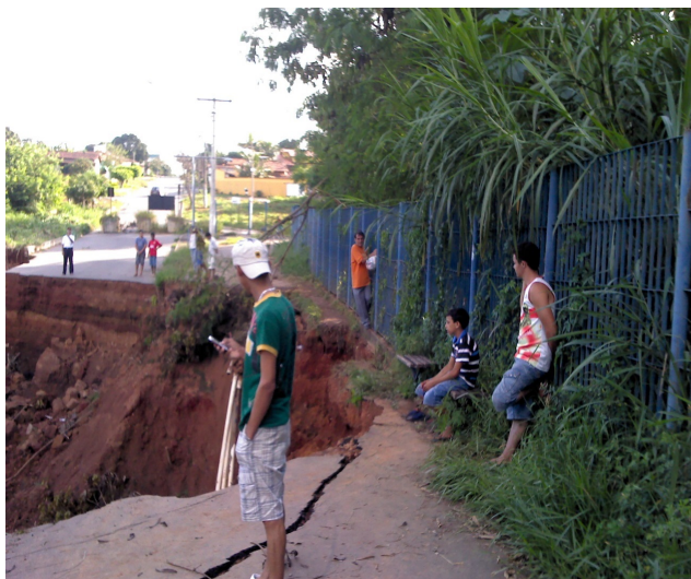
Figura 8: Desmoronamento de rua junto ao parque
