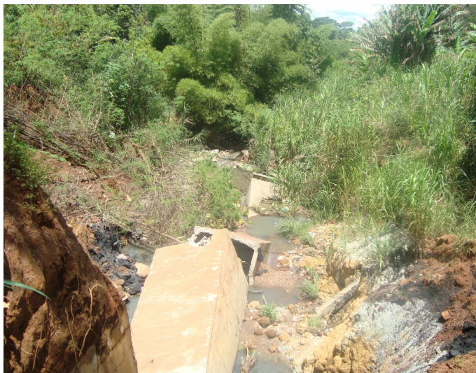
Figura 6: Degradação do fundo de vale e margens do Córrego Tamandua
