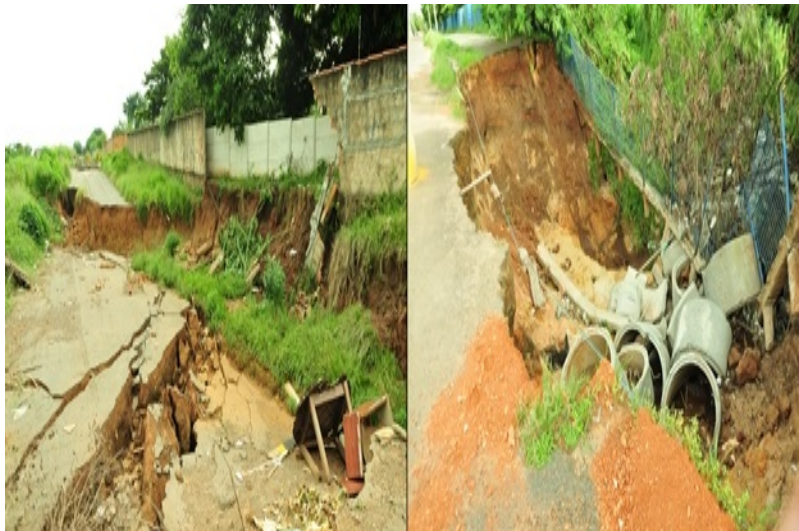
Figura 12: Degradação de ruas que acessam o parque
