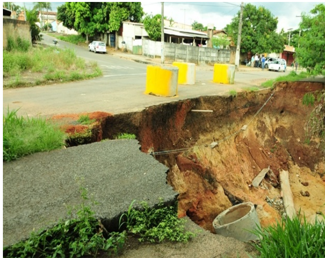
Figura 9: Desmoronamentos de ruas na vizinhança do parque
