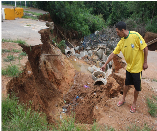
Figura 10: Rompimento de drenagem urbana na vizinhança do parque
