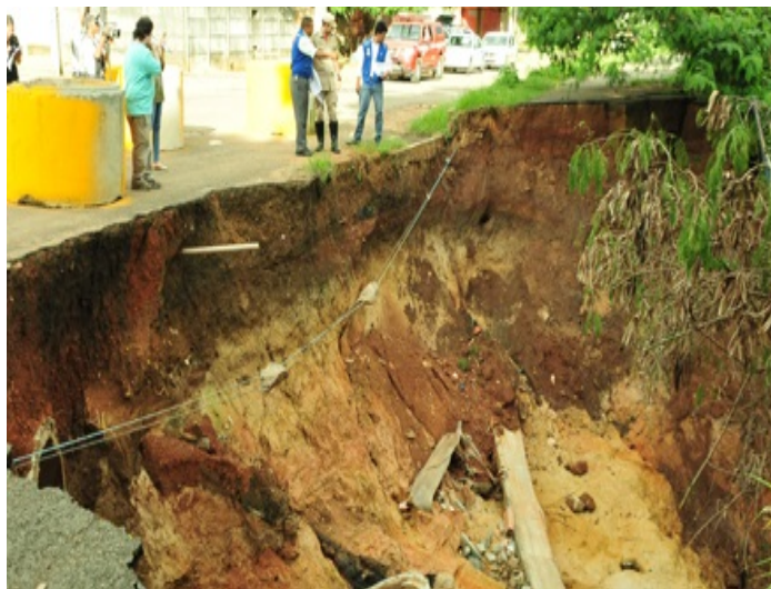
Figura 4: Desmoronamento em rua vizinha ao parque
