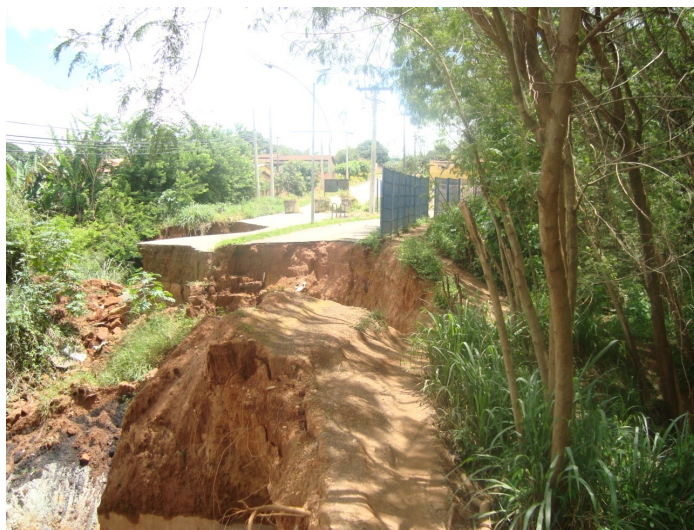
Figura 5: Erosão tomando conta do parque
